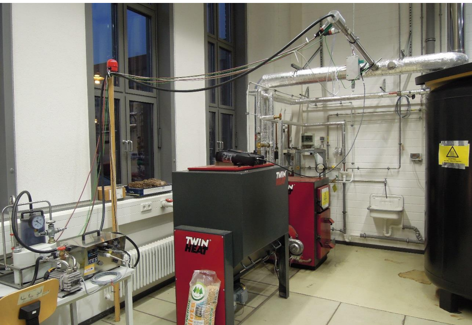
Abbildung 5.20: Pelletkessel mit Abgasmessstrecke
