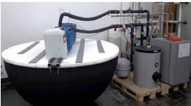
Abb. 1: Eisspeichermodellprüfstand mit Eisspeicherhalbkugel (links), Regenerationswärmespeicher (Mitte) und Wärmepumpe (rechts)
