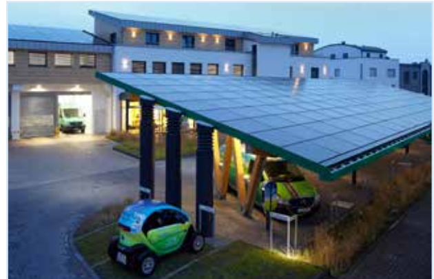
Solarcarport mit Ladesäulen in Hilden (©Bäckerei Schüren)
