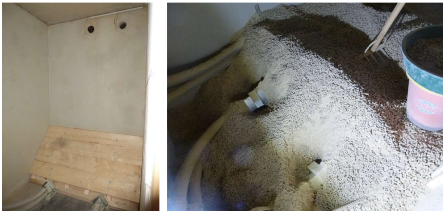
Abb. 4: links: leerer Speicher mit Ansaugsonden am Boden, Schrägboden sowie Einblas- und Absaugöffnung in der Rückwand; rechts: weitgehend leerer Speicher mit Holzstaubansammlungen im Bereich der Ansaugsonden (Fotos: Spessert)
