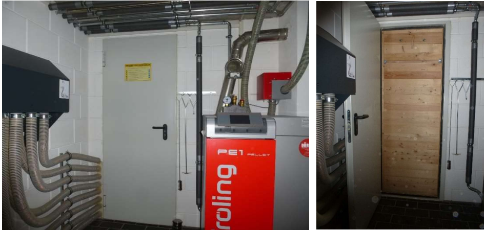
Abb. 3: Heizungskeller mit Ansauganlage, Tür zum Speicher und Heizkessel (Fotos: Spessert)
