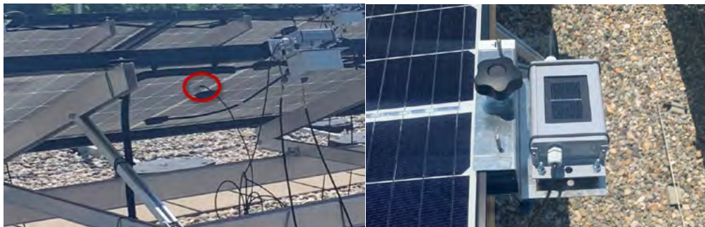
Abb. 1: Darstellung der Sensoren: Ein Temperatursensor auf der Rückseite eines Moduls (links, rot). Der Bestrahlungsstärkesensor befindet sich an der Moduloberseite in identischer Ausrichtung zur Modulfläche (rechts) [4].
