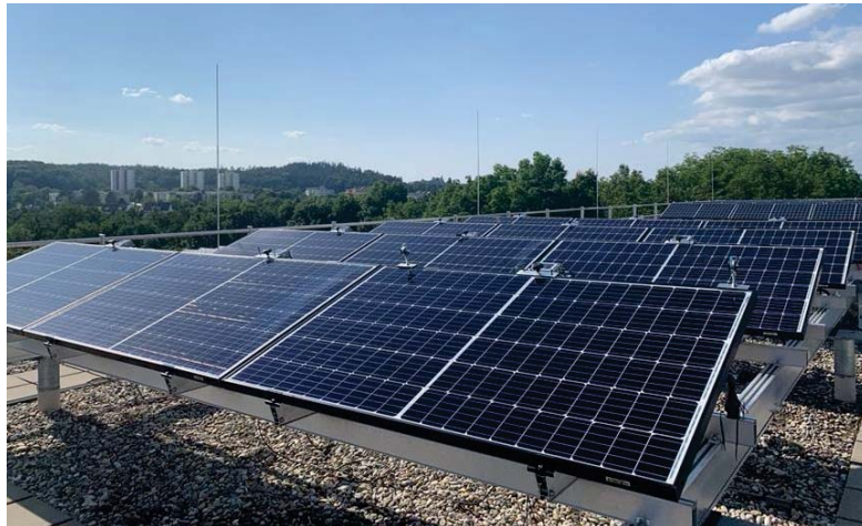
Abb. 1: Darstellung der Silizium-Test Strings auf dem Dach des ZME
